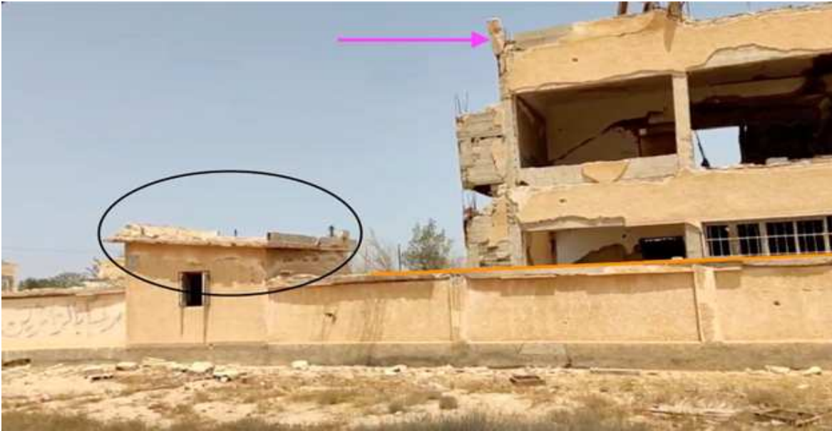
صورة 4: صورة المبنى المتهدم الفعلي والجدار الجنوبي ومبنى صغير على حافة المدرسة.
