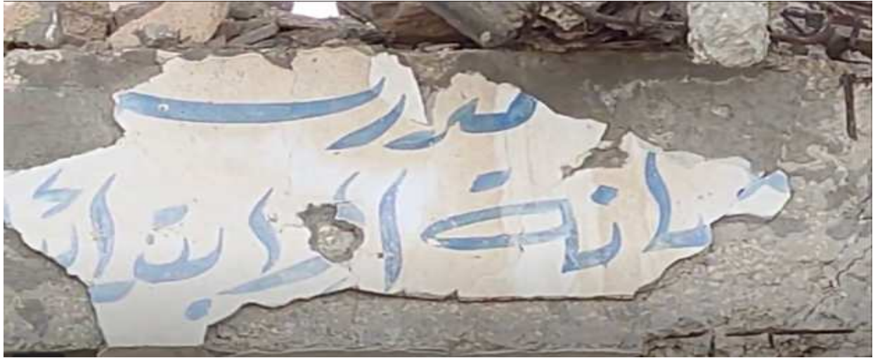
صورة 2: يمكن رؤية جزء من لافتة المدرسة الابتدائية على جانب المبنى المدمر.
